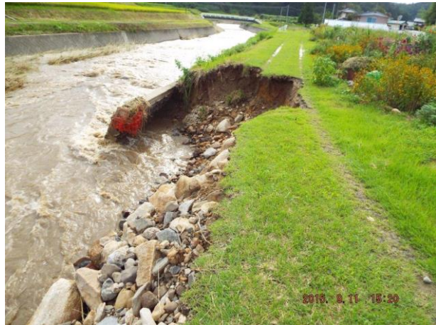
谷田岸地区 河川道路が崩落
