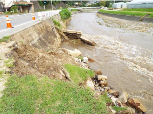
谷田岸地区 国道沿いの路肩崩れ
