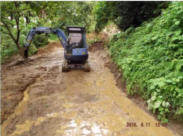
馬館地区 住宅に行く道が山崩れて修復中
