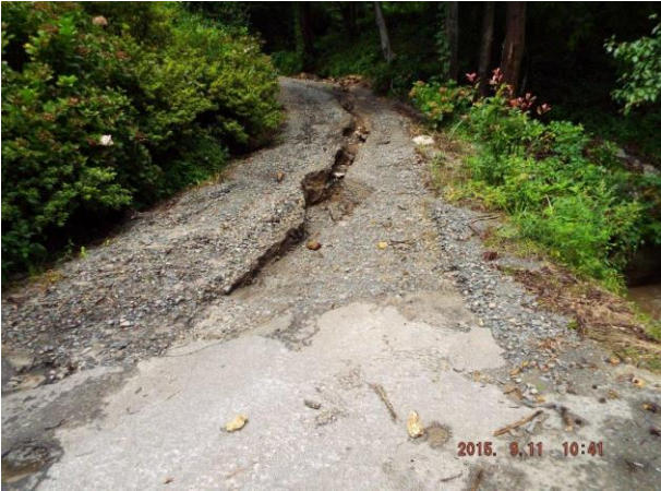
東部地区 住宅に行く道車がやっと、走れるくらい 道が割れた
