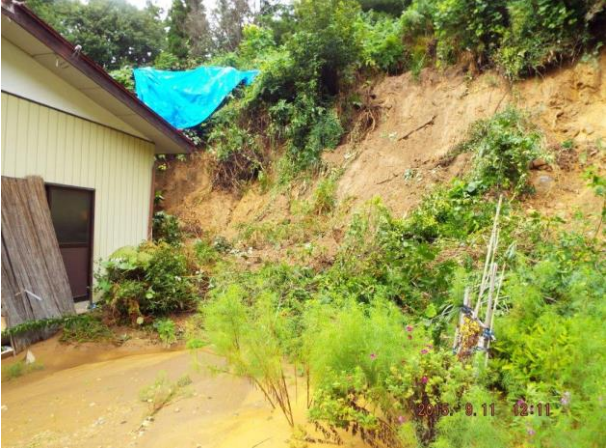
東部地区 裏山が崩れて住宅まで
